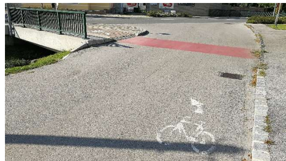
Querungshilfe Hauptstraße Sigleß (touristische Radroute) mit steiler Bordsteinkante
