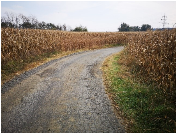
Schlechter Belagszustand am Weg zwischen Fa. Boxmark und Raab
